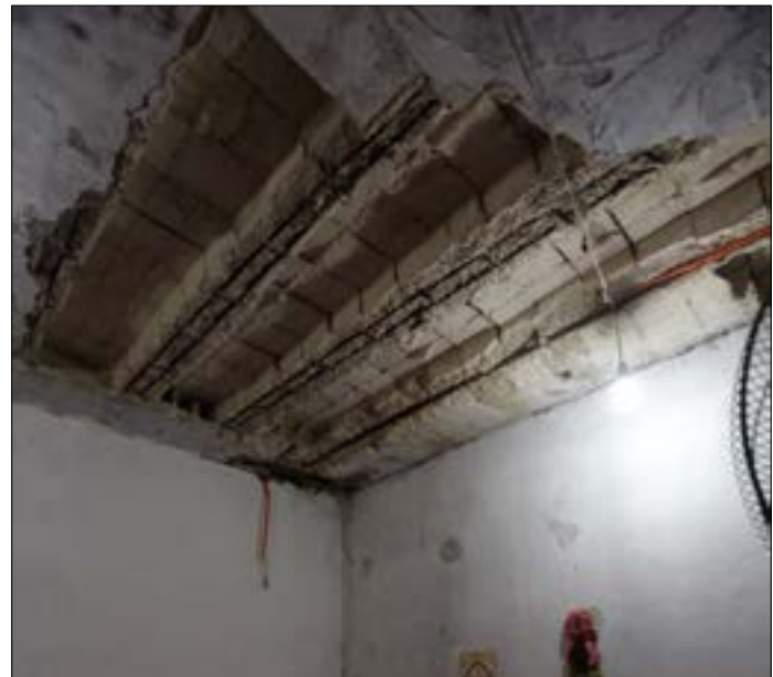
تدعيم المبنى بالحديد سيجعله آمناً مؤقتاً (مروان طحطح)
